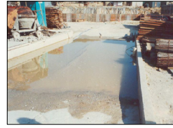
Wash Through - Tempat membasuh roda kenderaan dan jentera pembinaan.
