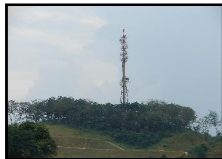
Menara Telekom Yang Terletak di Puncak Bukit Taman Rimba Alam
