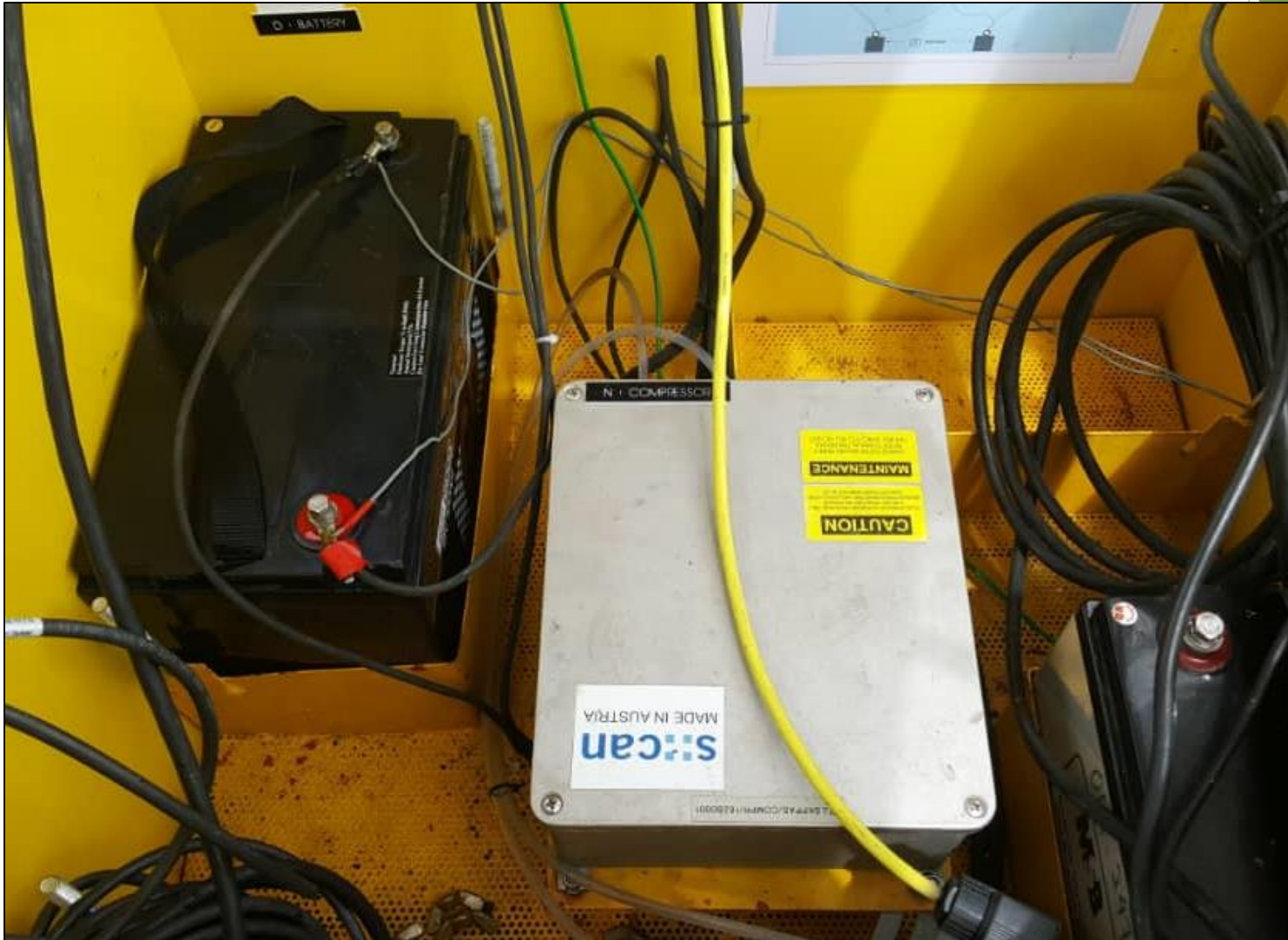
Gambar: Compressor sediada di tapak
